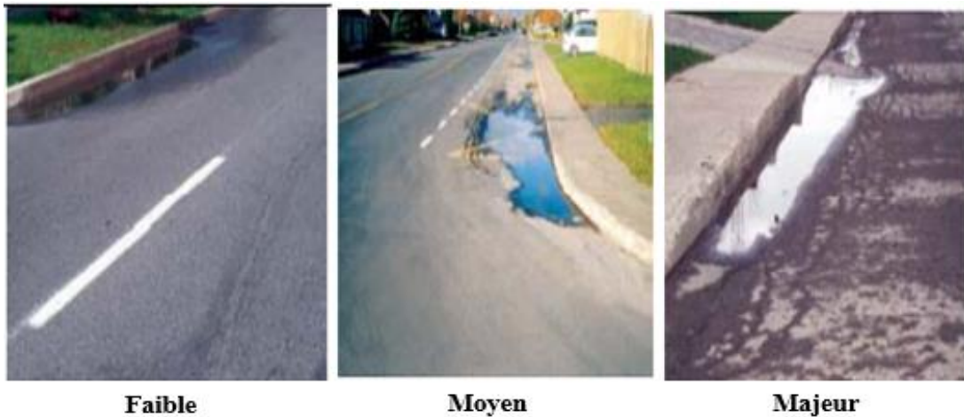
Figure 2.7. Désordre du profil
