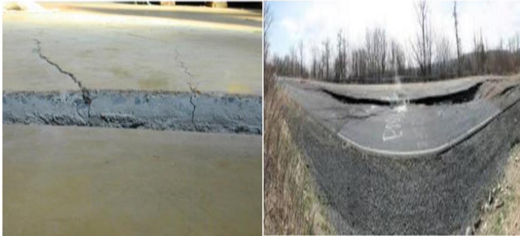
Figure 2.3. Retrait gonflement d'une chaussée
