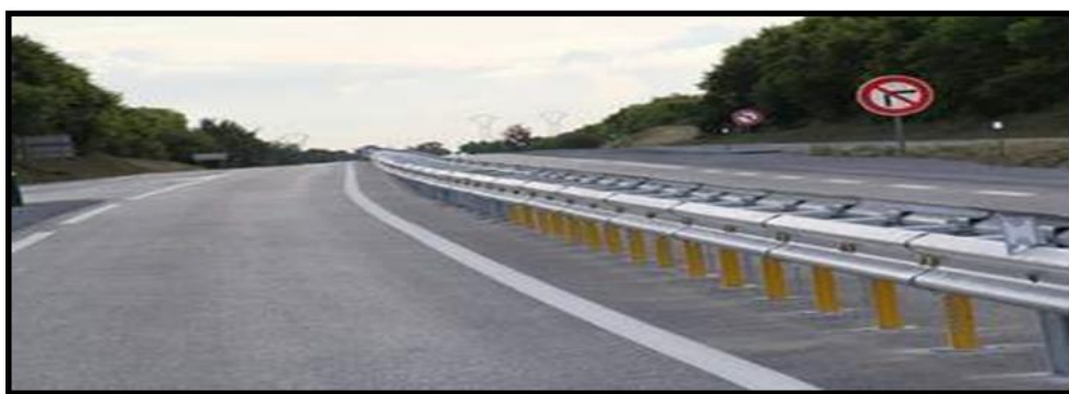
Figure XI-12 : photo d'une glissière de sécurité
