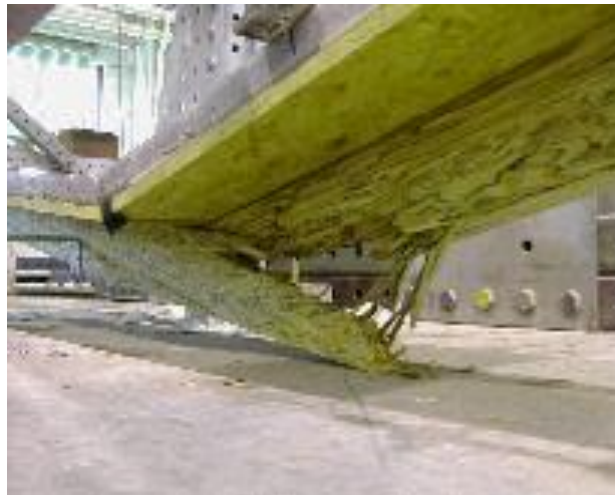
Fig III-16 : Rupture au niveau de la poutre en bois.
