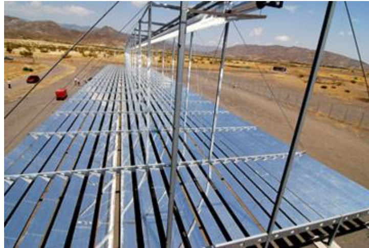
Figure I.8: Les centrales solaires à miroir de Fresnel.
