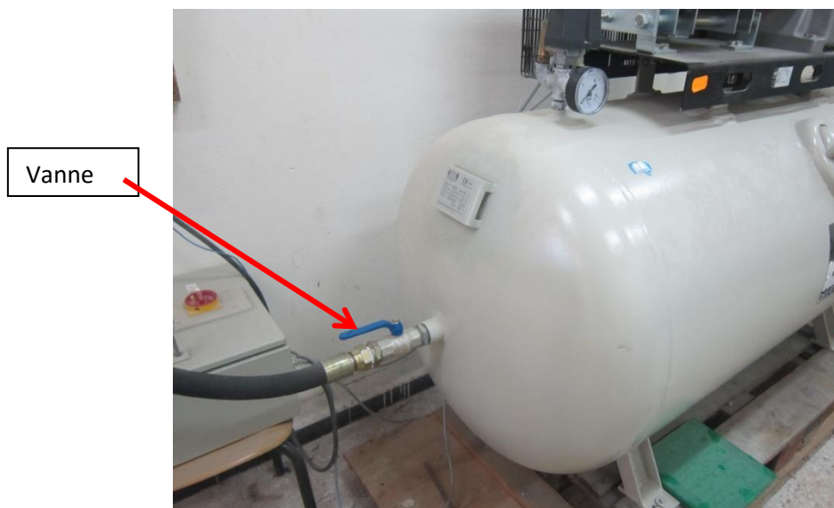
Figure III.2: Vanne en position ouverte.
