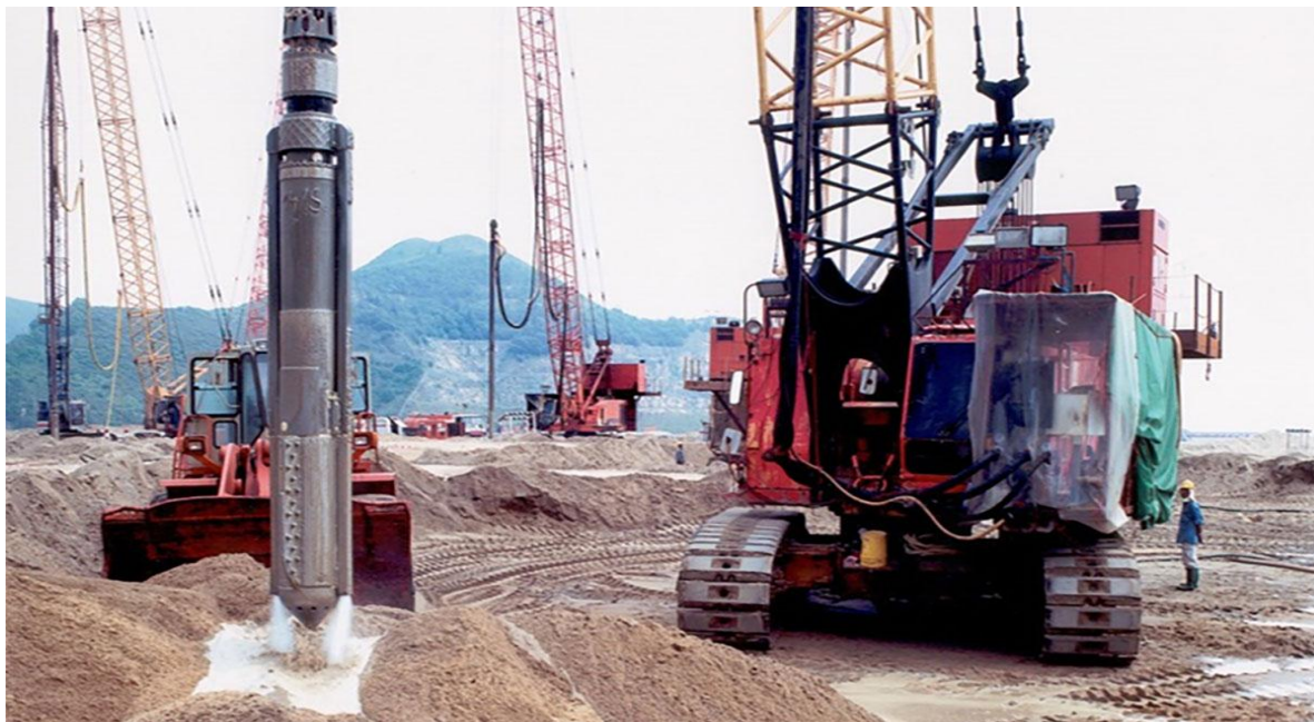
Figure 1. 5. Vibro-compactage : Procédés d'amélioration et de renforcement de sols sous actions sismiques. (Centre de formation [CFMS])
