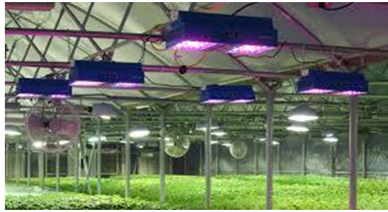
FIGURE 2.5 – Renforcement de l'éclairage avec des lampes.
