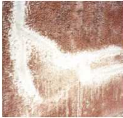
Figure I.10 : calfeutrement de fissures à l'aide d'un mortier à base de liants hydrauliques. [17]
