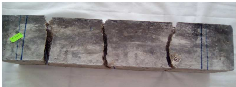
Figure III.5 : Rupture de l'éprouvette en béton témoin.
