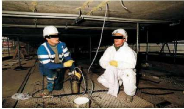
Figure I.8 : Injection des fissures au pont de Châlons-en-Champagne. [22]
