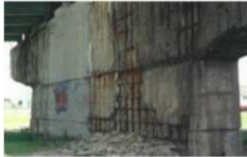
Figure I.2 : Structure atteinte par l'attaque des chlorures. [13]
