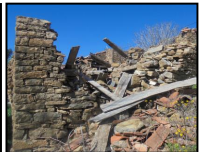
Figure177 : effondrement du mur.
