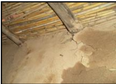
Figure173 : l'effet d'humidité sur l'enduit
