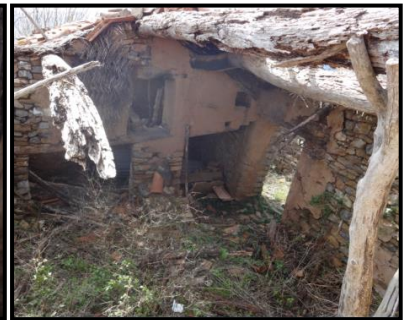
Figure182 : fléchissement du toit.
