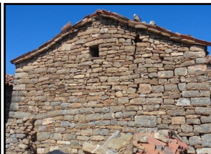
Figure176 : fissuration verticale sur les murs.
