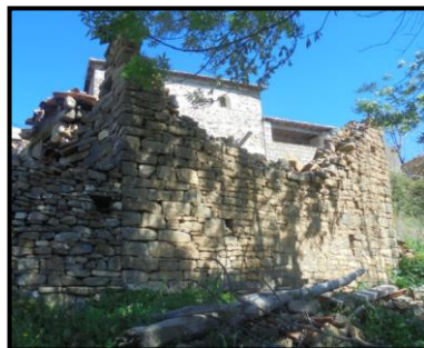
Figure175 : effondrement partiel du mur.
