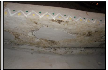
Figure 174 : dégradation des finitions
