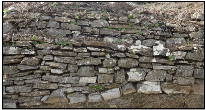
Figure179 : invasion des végétaux sur la maçonnerie.
