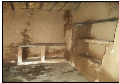
Figure174 : infiltration de l'eau
