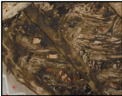
Figure180 : le pourrissement du bois.
