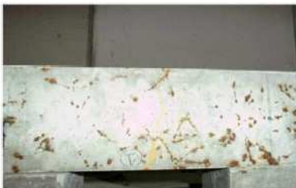
Figure 3.12 : Corrosion des fibres des BFM
