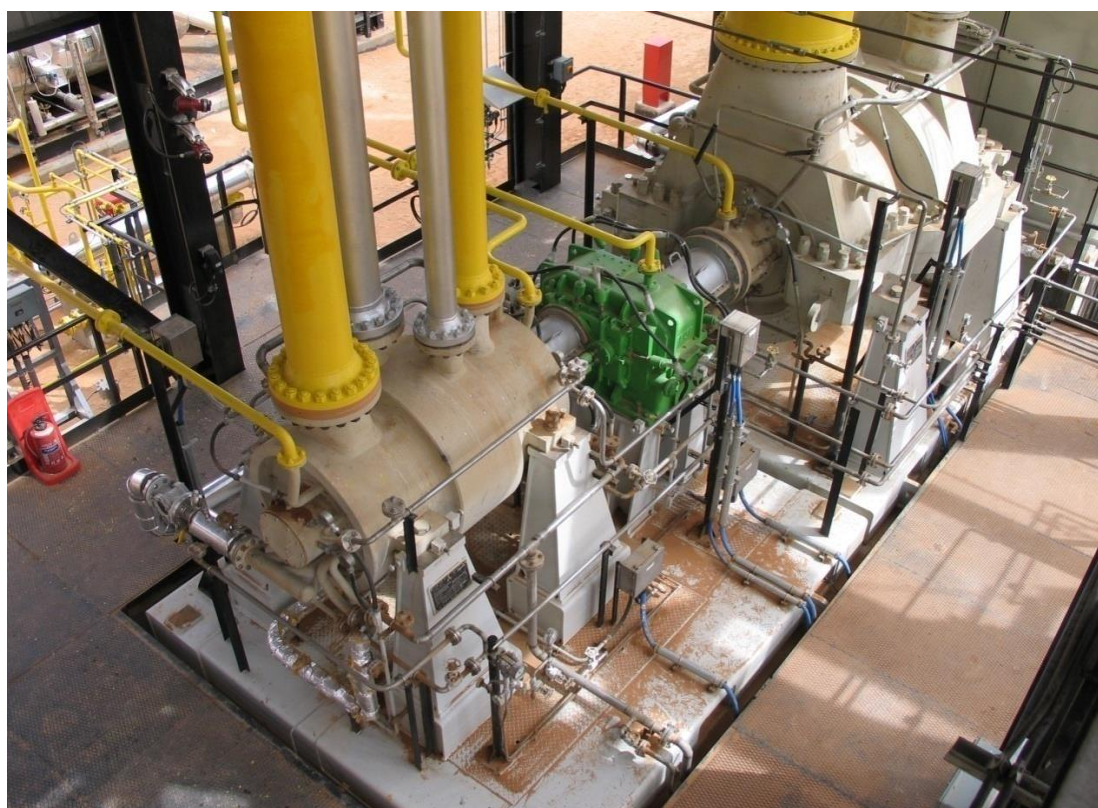
Figure I.10 : Compresseur centrifuge à quatre étages
