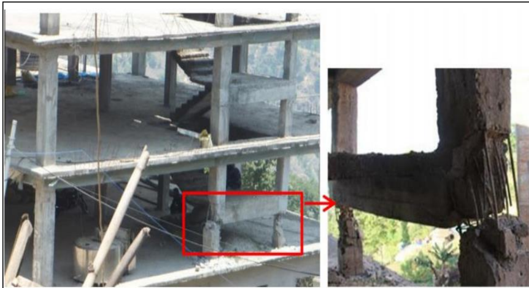
Figure 1.2: Rupture fragile des poteaux par effet de poteau court due à la présence de la cage d'escalier (Népal, 2015) [2].
