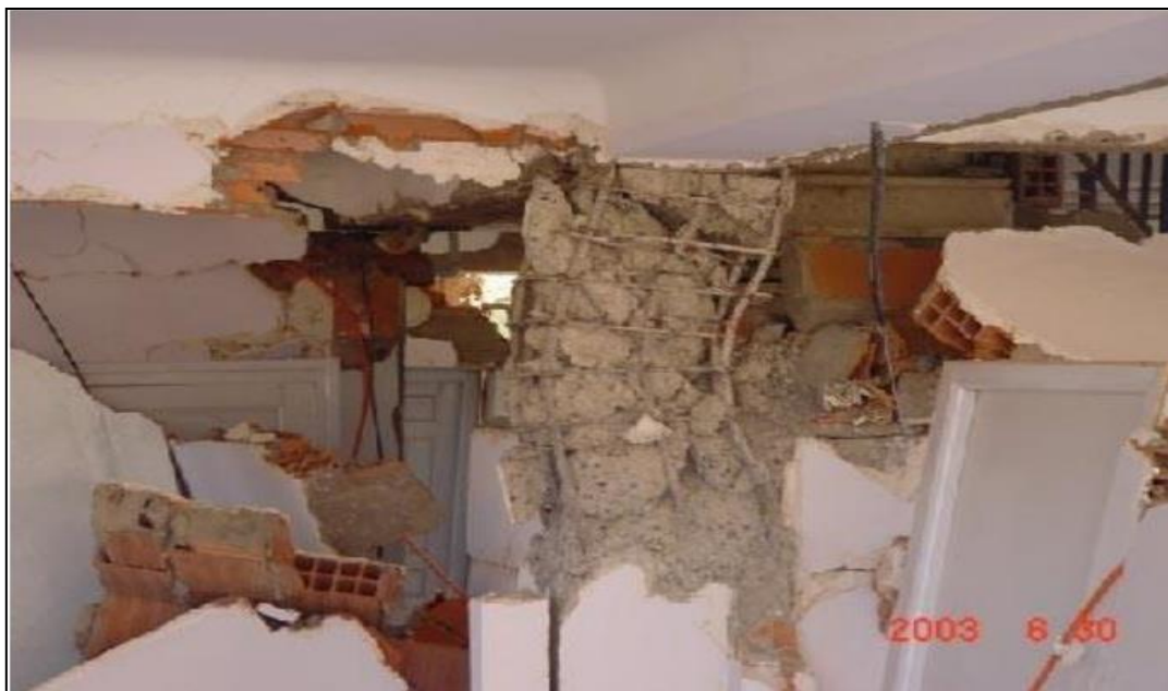
Figure 1.1: Rupture brutale par effet de poteau court due à la présence de la cage d'escalier qui divise les poteaux souvent à mi-hauteur de l'étage (Boumerdès, Algérie, 2003) [1].
