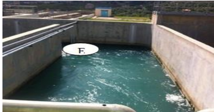
Figure IV.5: Injection du sulfate d'alumine.
