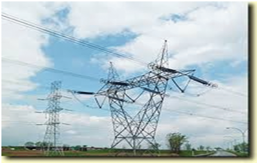
Figure (I.1) : un pylône des lignes électriques.
