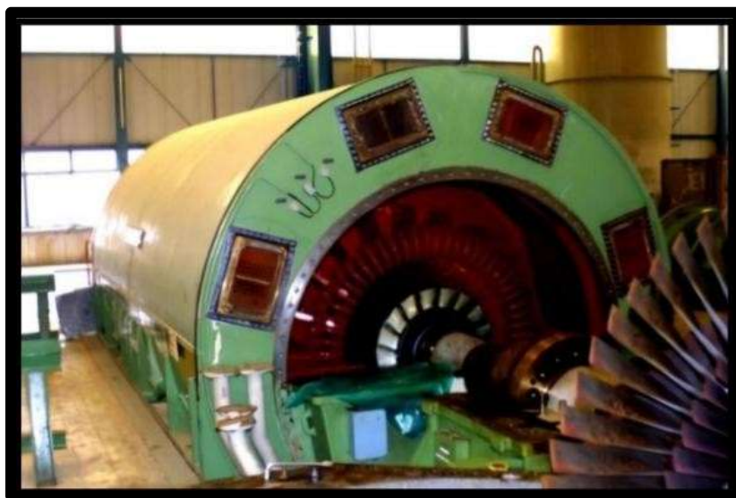
Figure I. 5: L'alternateur de la centrale
