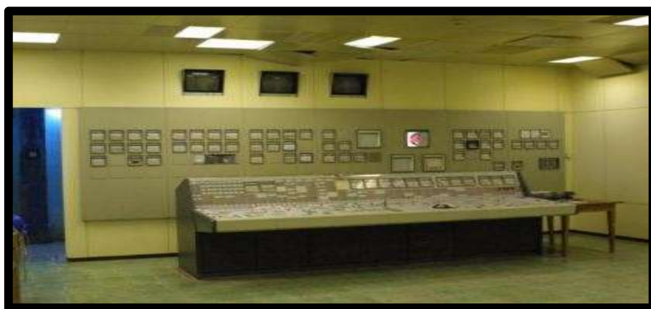
Figure I. 8: Salle de commande de CAP-DJENET
