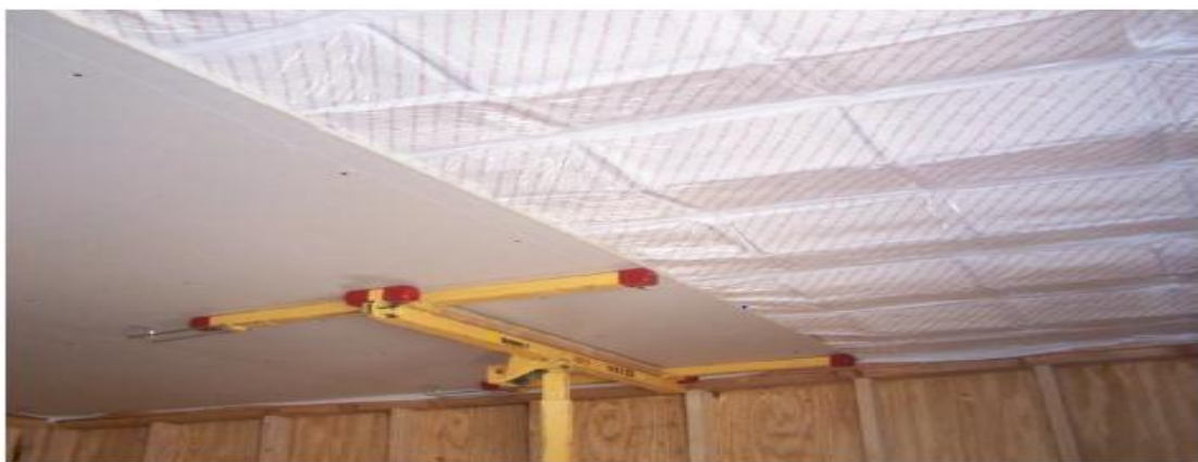
Figure II. 4 : Application de MCP dans le plafond.
