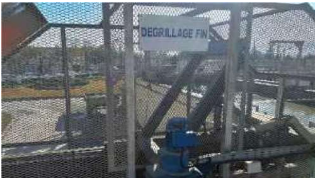
Figure 8 : Dégrillage fin (originelle ; 2023)
