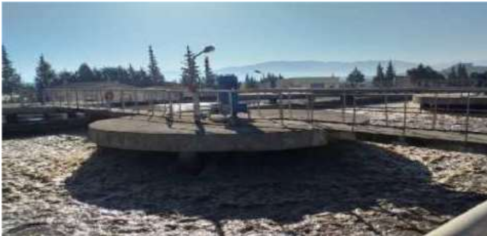
Figure11: Le bassin d'aération (original)
