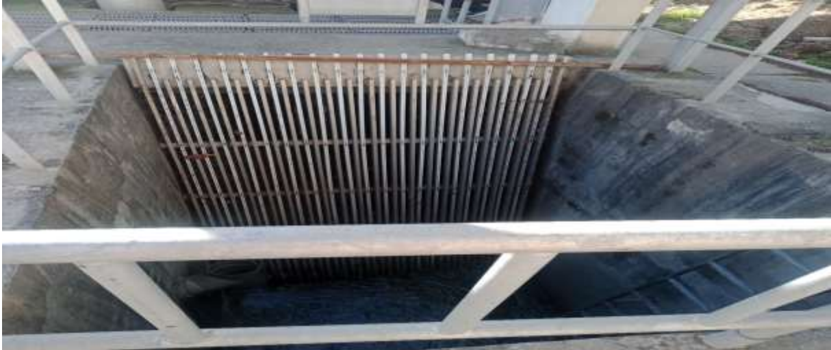
Figure 7: Dégrillage grossier (originelle ;2023)
