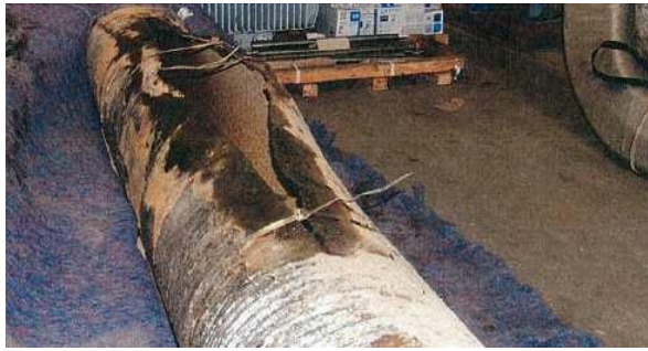
Figure I.8 Rupture d'une canalisation dans un stockage d'hydrocarbures [14].
