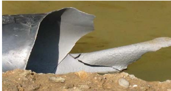
Figure I.7 Eclatement d'une canalisation d'oxygène [14].
