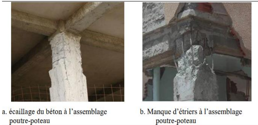
Figure I. 7 : Écaillage et graves dommages au nœud [1]
