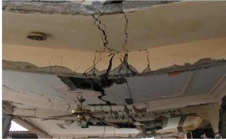
Figure I. 4 : Fissuration par flexion dans la travée des poutres (Séisme de Boumerdes, Algérie, 2003) [1]
