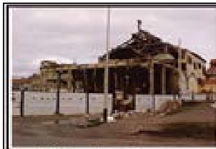
4/ Bâti en état vétuste avancé (Hangar, dépôt).
