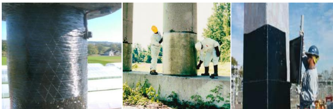
Figure I.13 : poteaux en BA confiné par matériaux composites.
