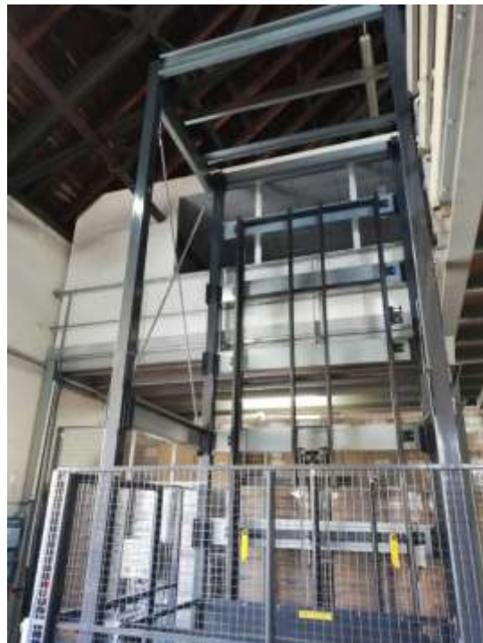
Figure 23: Monte charges électrique industriel
