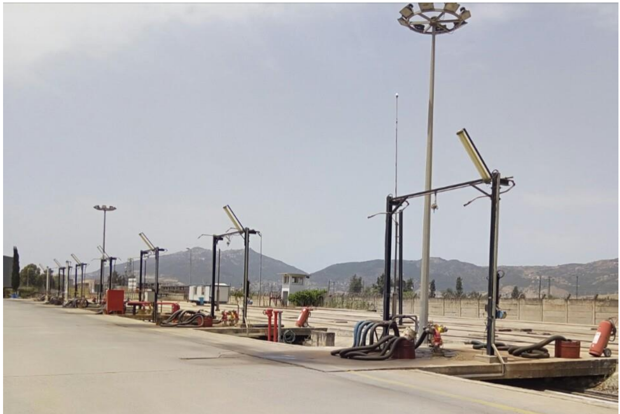
Figure I.5: poste de déchargement des camions.
