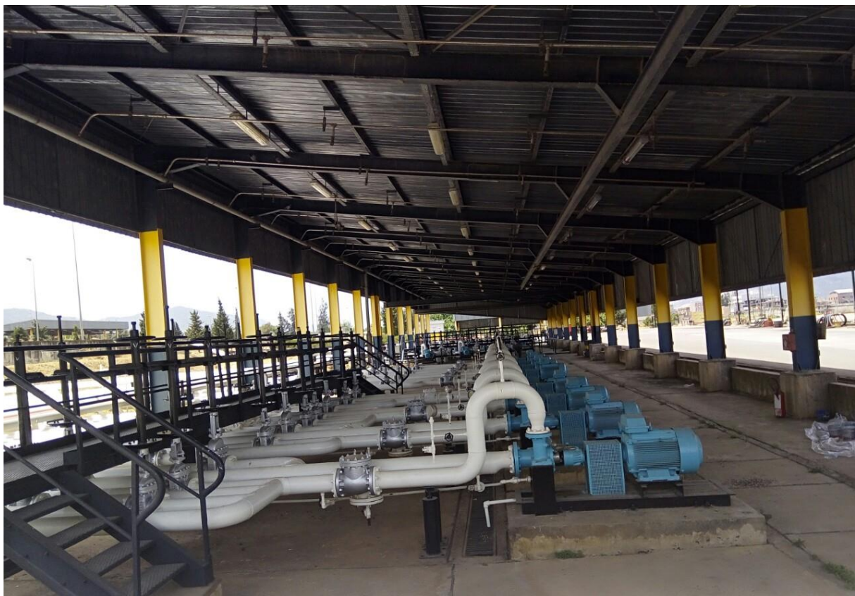
Figure I.6: pompes de chargement et de déchargement.
