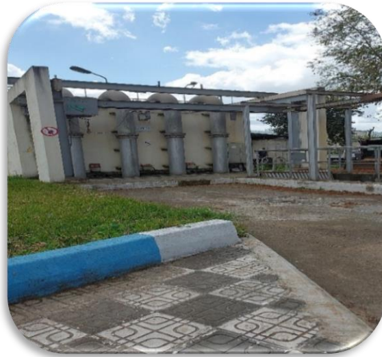
Figure 8. Poste de relevage
