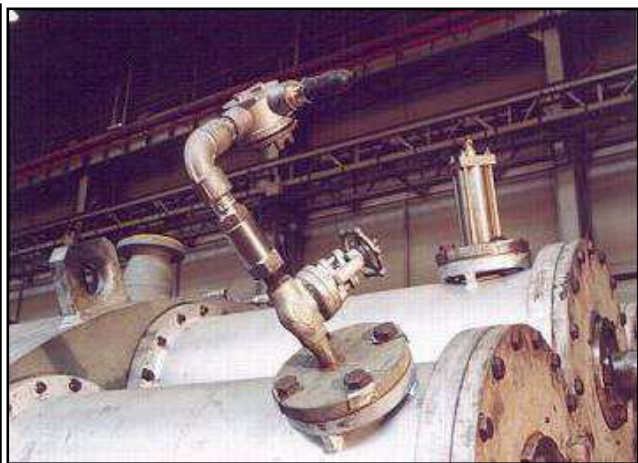
Fig.3.6: Détecteur de flamme
