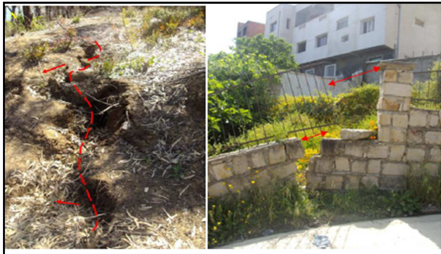
FIG.I.16 : Les désordres au niveau du glissement de Tizirt.
