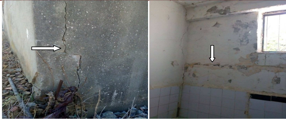
Fig. II.10 : Fissuration des murs
