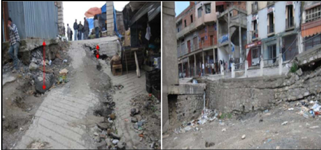
FIG.I.17 : Les désordres au niveau du glissement d'Ain El Hammam
