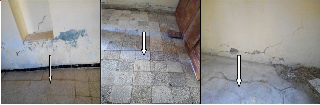
Fig.II.7 :Soulèvement et bombement des parterres
