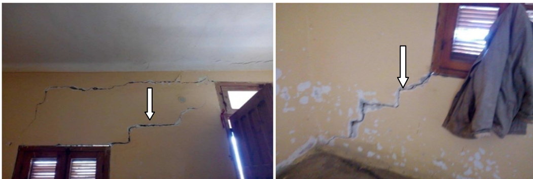
Fig. II.9 : Fissuration au niveau des fenêtre
