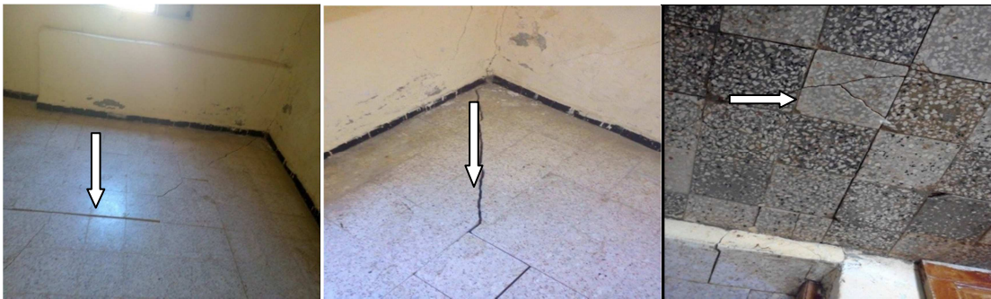
Fig.II.8 : Fissuration de la dalle au sol
