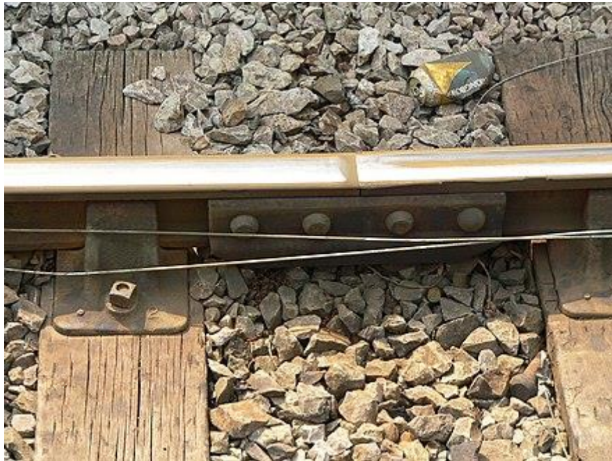
Figure VI-12: Tirefond sur les traverses en bois.
