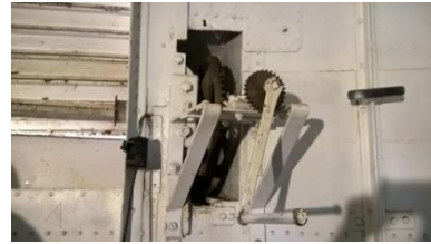
Outil servant à ouvrir la trappe. Photo prise le 25/04/2016.
