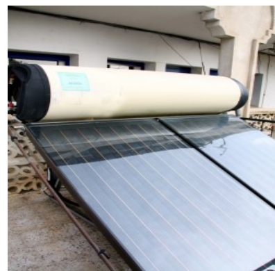
Figure 226 : Chauffe eau solaire Source : http://www.energy.gov.dz
