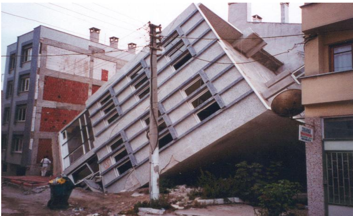
Figure 3.30 : Renversement d'une structure sous l'effet de la liquéfaction sisme Turquie 1999 (d'après Peter M. Byrne et al, 2008).
