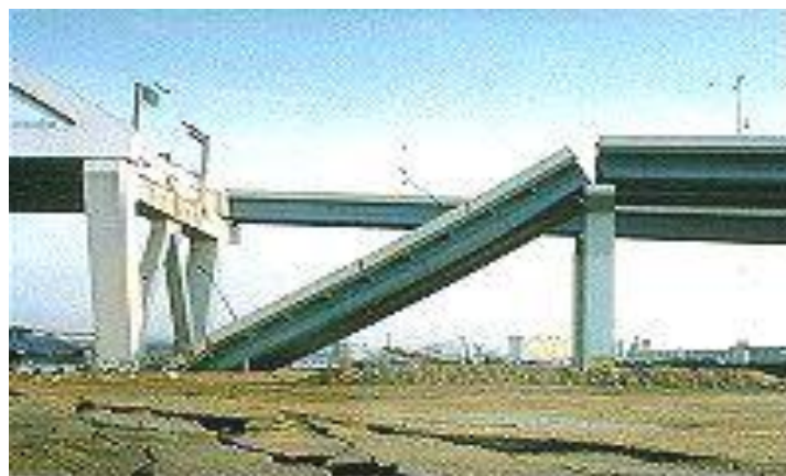
Figure 3.20 : Endommagement des ponts : Un tel dommage peut avoir des conséquences désastreuses, empêchant même les opérations de sauvetage. Les mouvements induits par la liquéfaction peuvent pousser les bases hors du point où le pont enjambe l'appui, dans ce cas le pont lâche (d'après Jorgen Johansson, 2000).
