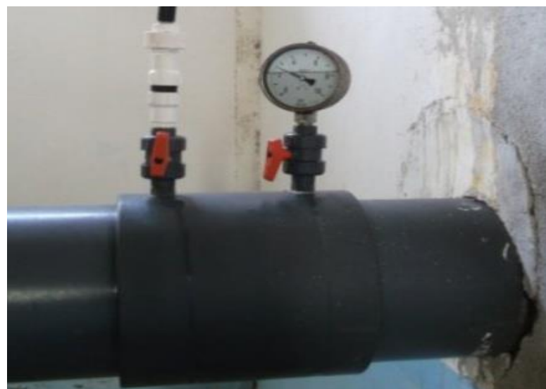
Figure III.7 : Point d'injection de l'acide chlorhydrique.
