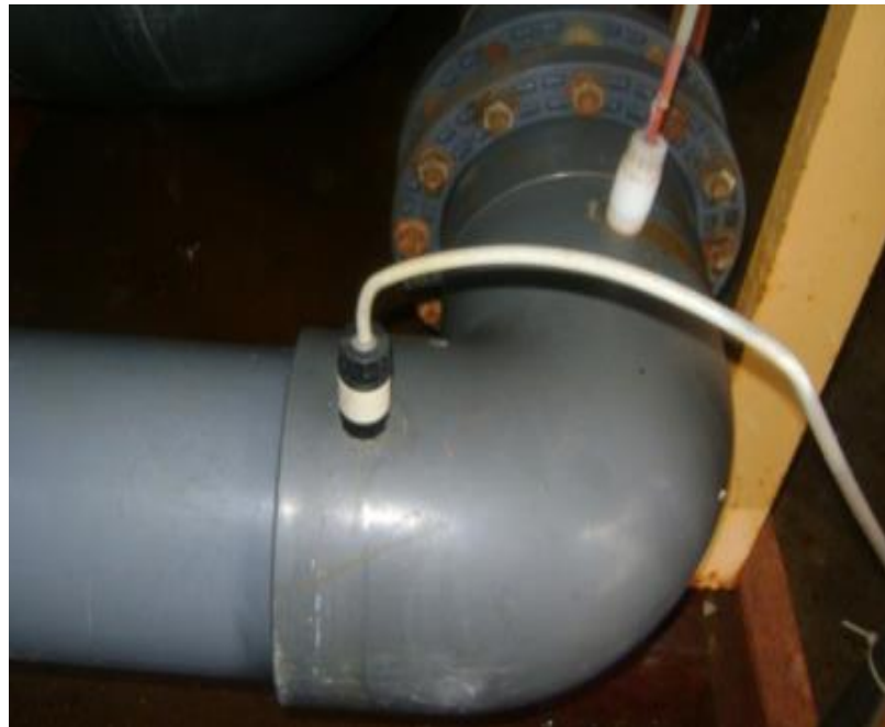
Figure III.10 : Point d'injection du Meta-bisulfite de sodium.
