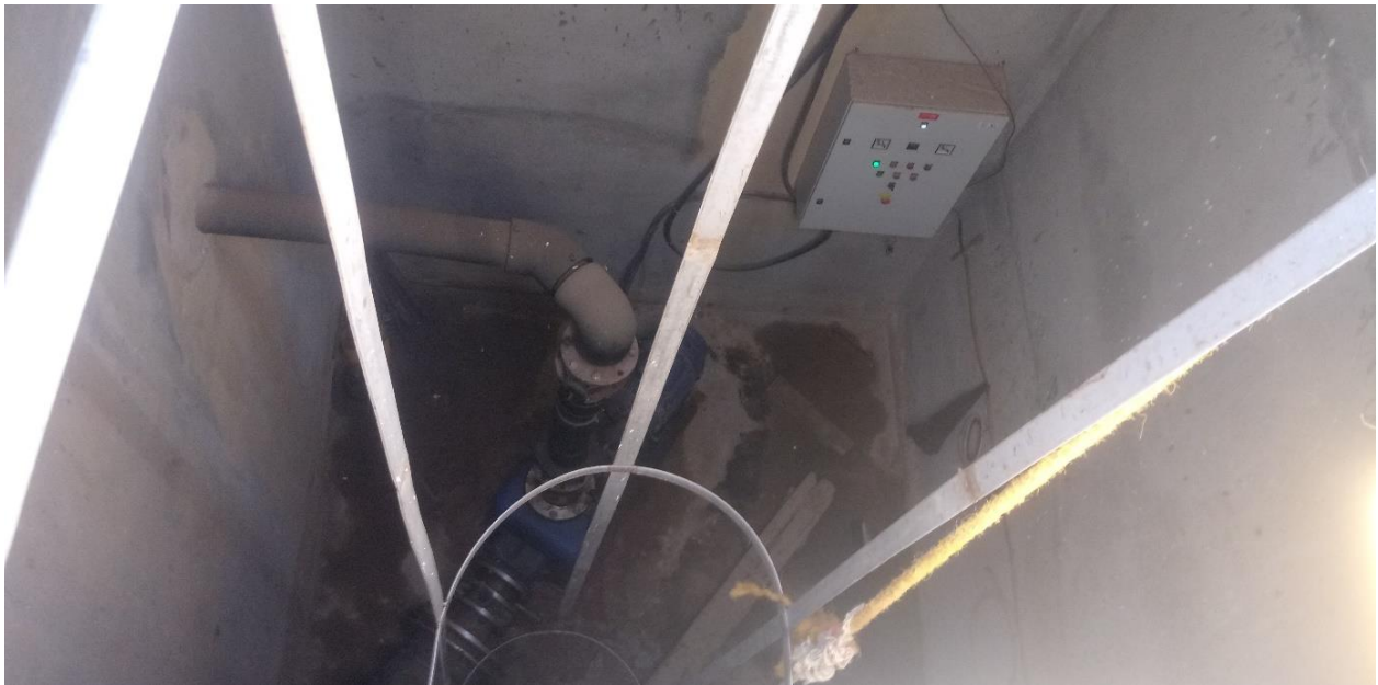
Figure III.3 : Prise d'eau brute.
