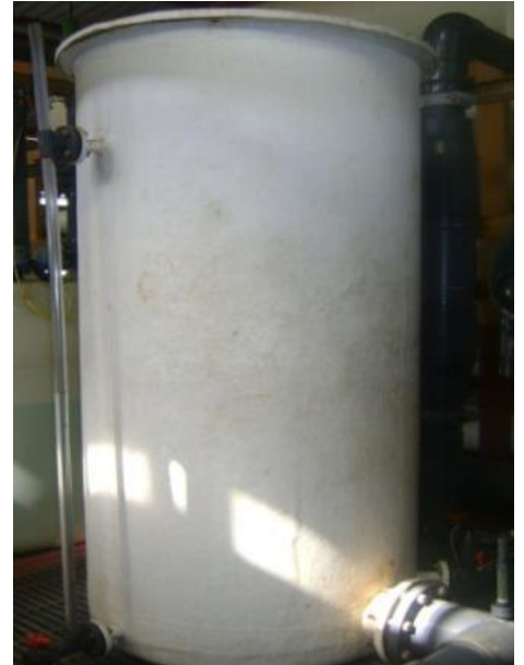
Figure III.15 : Réservoir tampon de stockage de l'eau traitée.
