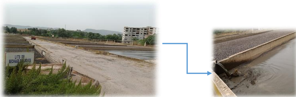
Figure 30 : Lits de séchage des boues
