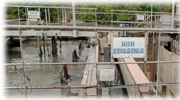
Figure 19 : Bassins de Dessablage-Déshuilage
