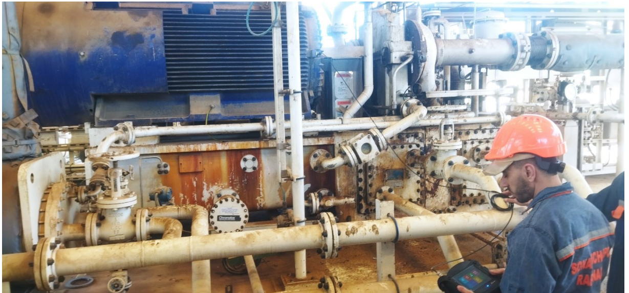
Fig IV.9 : Relevé des vibrations du Compresseur de la raffinerie d'Alger.
