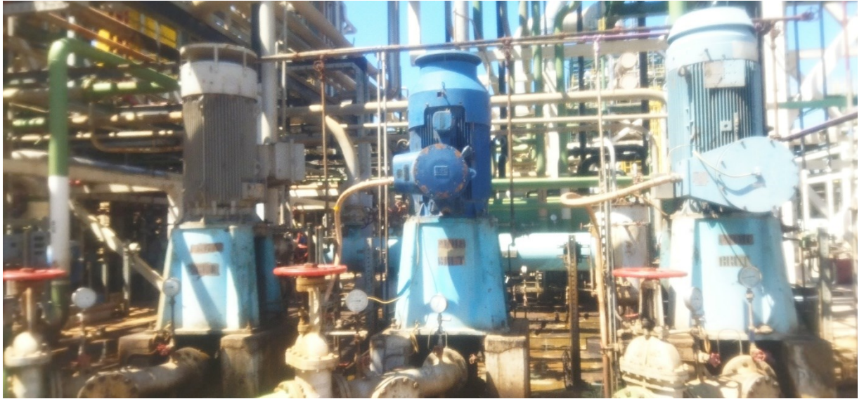
Fig. IV.24 : pompes verticales multicellulaires de la Raffinerie d'Alger.
