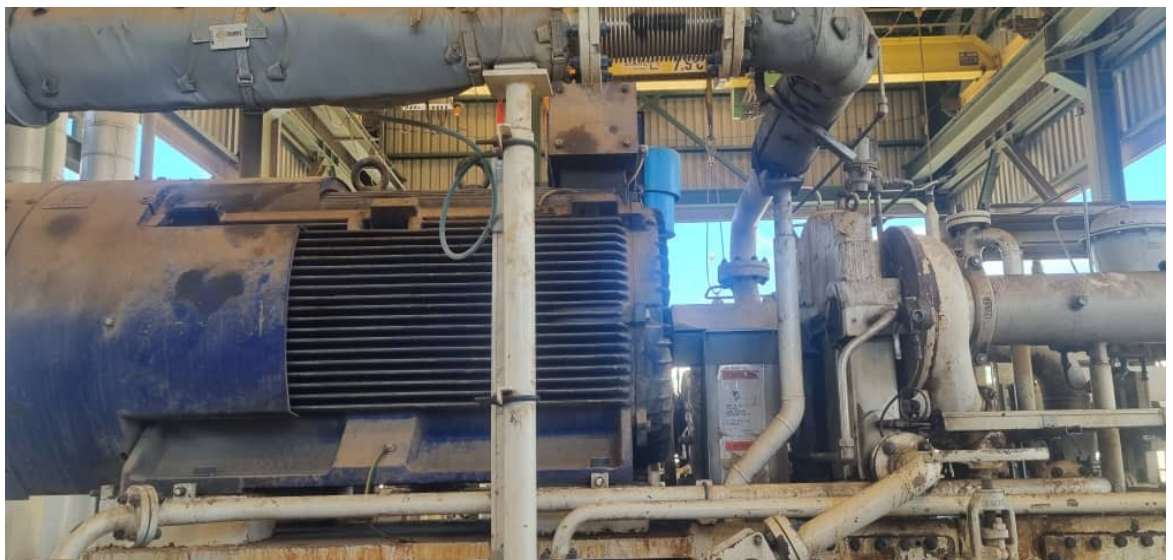
Fig IV.7 : Compresseur centrifuge FS-Elliott de la raffinerie d'Alger.
