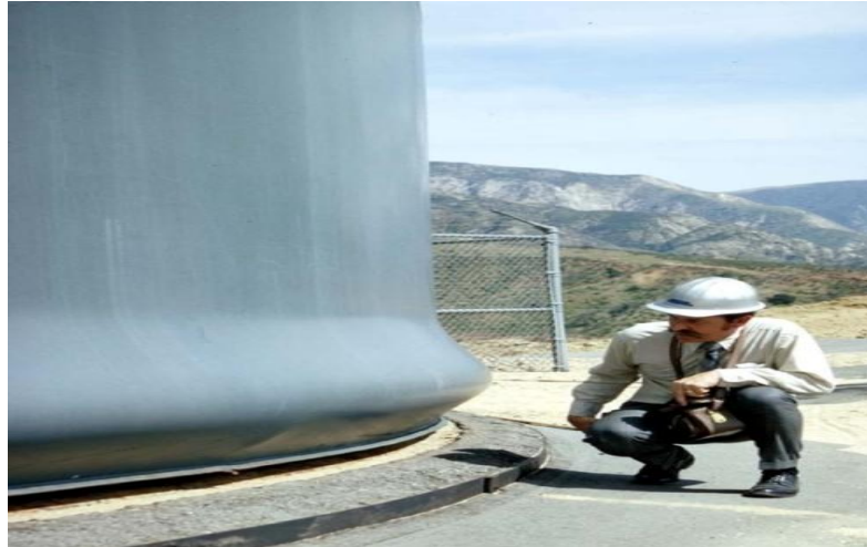
Figure III.3 : Flambement d'un réservoir métallique (NISEE, UNIVERSITY OF CALIFORNIA, BERKELEY PEER Center, Steinbrugge Collection No. S4183)
