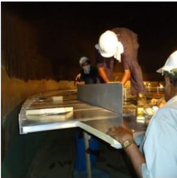
Figure I.6 : Toits flottants internes soudés
