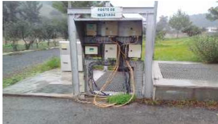
Figure 3 : Poste de relevage
