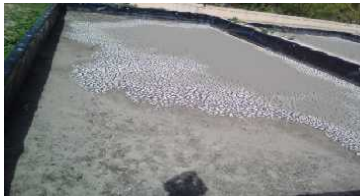
Figure 13 : Stockage des boues
