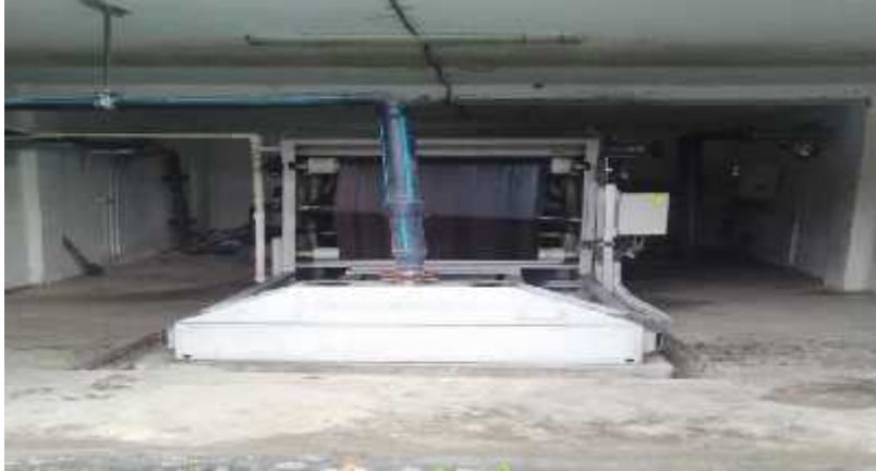
Figure 12 : Déshydratation des boues
