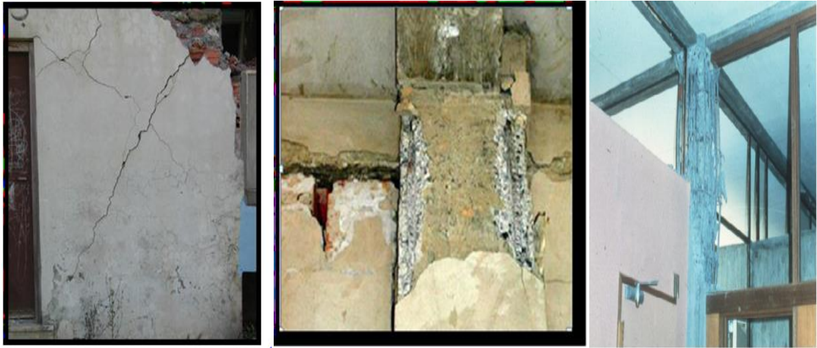
Figure II.10 : Fissures en « X », dislocation de la section, Rupture par écrasement du béton du au remplissage partiel [10]
