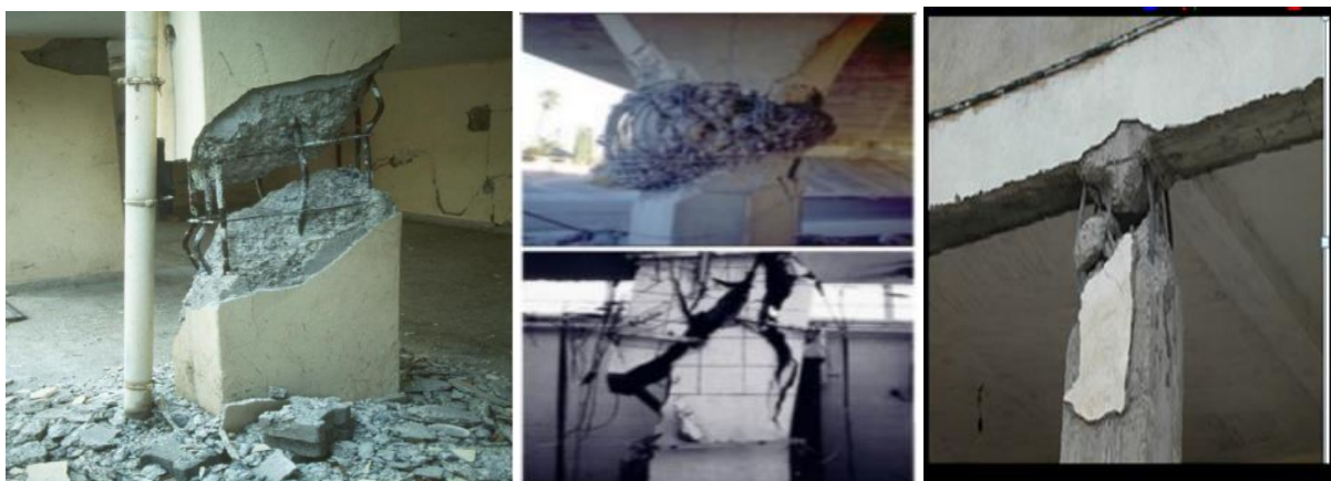
Figure II.12 : Rupture par flambement de poteaux [34].
