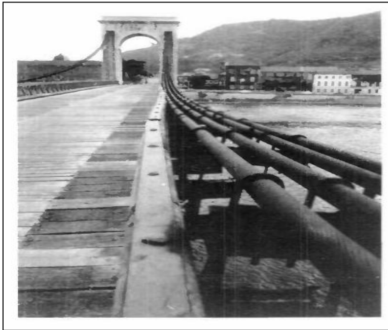
Figure 2-11: Déversement d'une membrure supérieure d'une poutre de rive suite au dérèglement de la suspension
