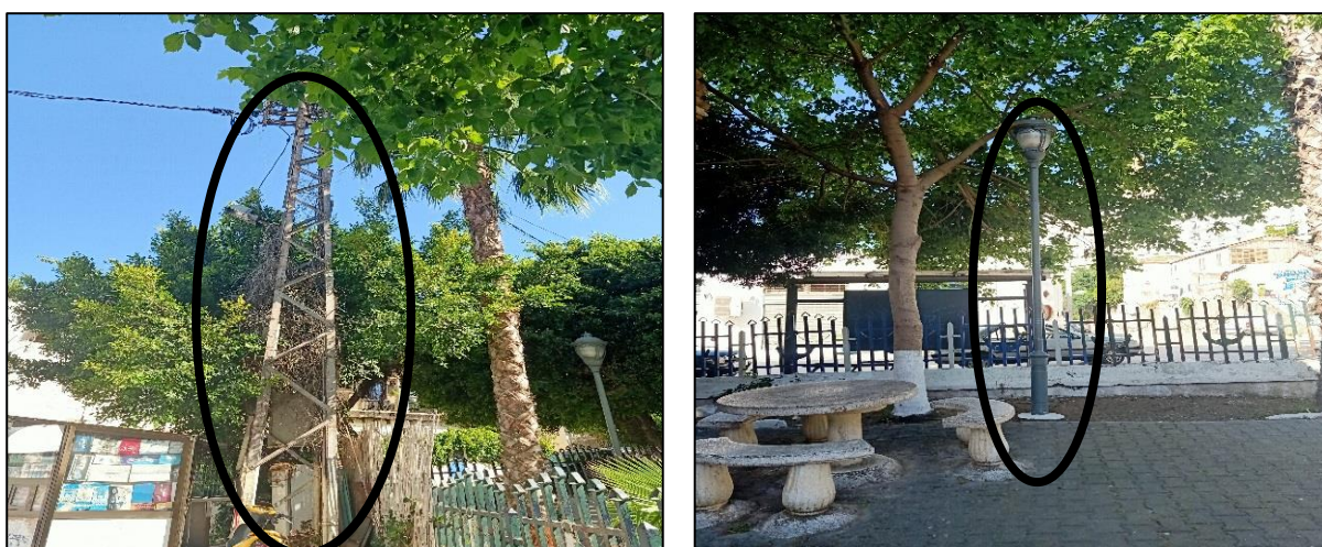
Figure 56 : Lampadaires existants autour du square de la porte Sarrasine. Source : auteur.
