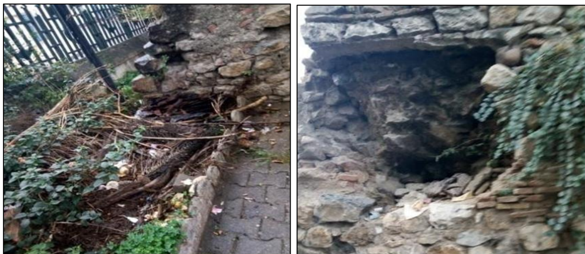
Figure 57 : Etat d'hygiène dans square de la porte Sarrasine. Source : auteur.
