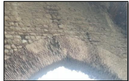
Figure 71 : Altération de brique Source : Auteur
