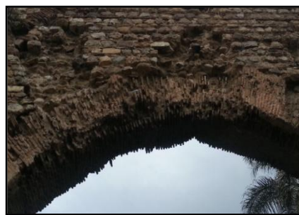
Figure 65 : altération de brique Source : Auteur
