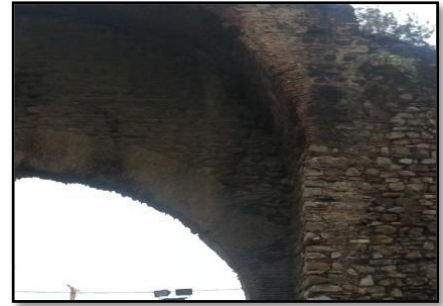
Figure 70 : Fissures importantes Source : Auteur 2020
