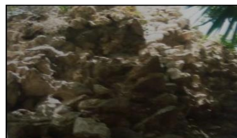
Figure 63 : Eventrement de la maçonnerie Source : Auteur
