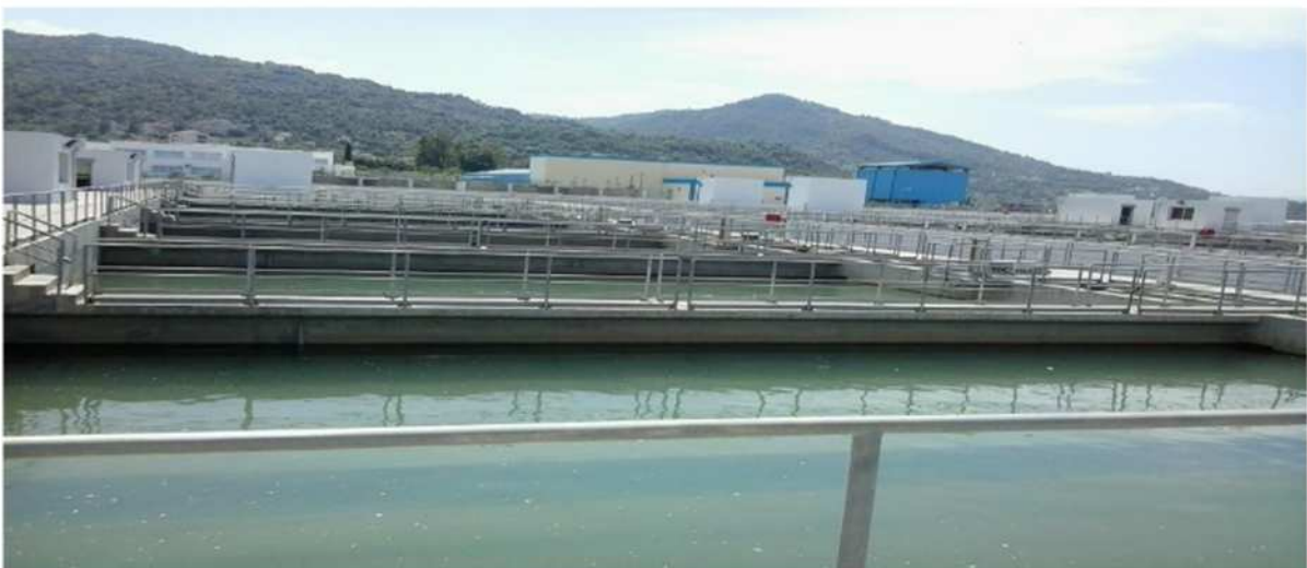
Figure 6 : Les deux filières de filtre à sable
