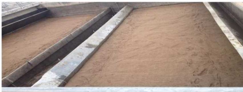
Figure 8 : Traitement des boues
