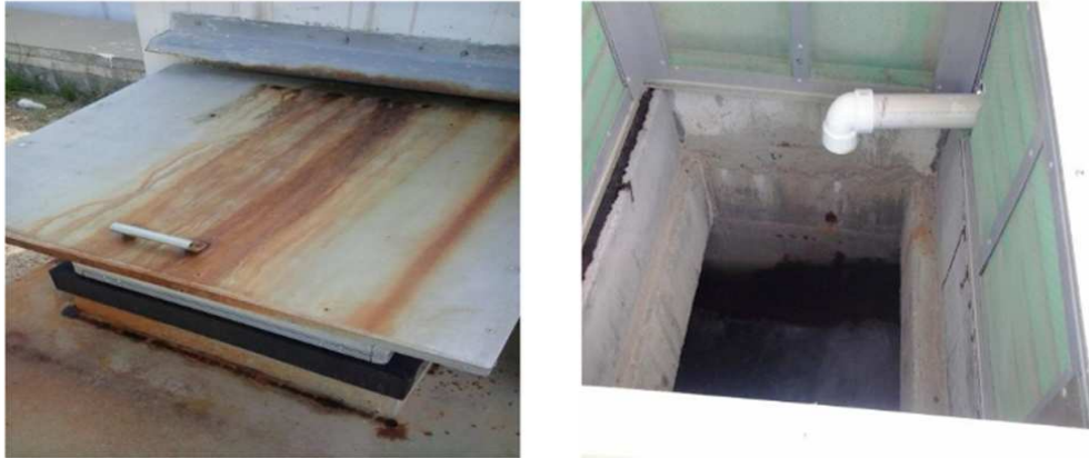
Figure 7: Cuve de contact pour la post-chloration
