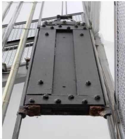
Figure II.3 : Contrepoids de l'ascenseur.
