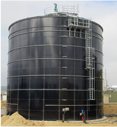
Réservoirs cylindriques verticaux
