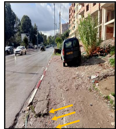
Figure 27 : Trottoir dégradé. Source : Auteurs, octobre 2023
