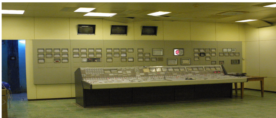
Figure I.10 : Représente la salle de commande de la centrale.
