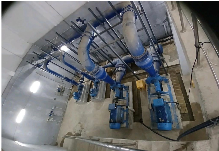
Figure II.13 : Station de pompage d'eau traitée [39].
