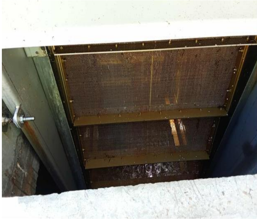
Figure II.5 : Dégrilleurs fin (B.N, A.M 2025).
