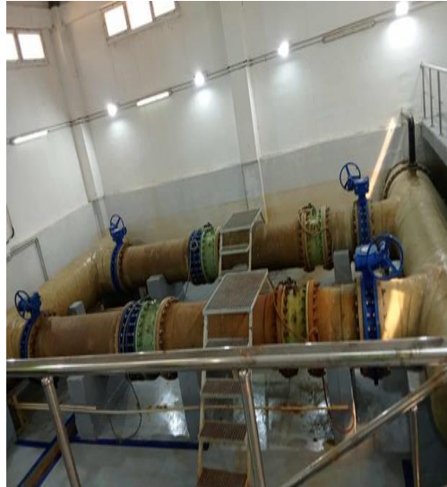
Figure II.9 : Les mélangeurs statiques de coagulation-floculation (B.N, A.M 2025).
