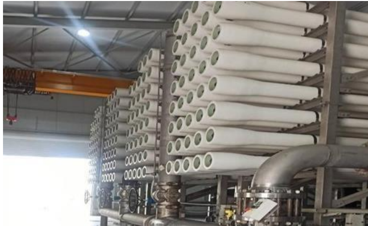
Figure II.11 : Unité d'osmose inverse [39].
