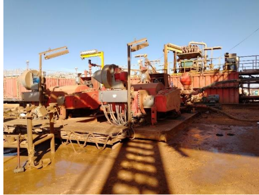
Figure I.9 : La pompe à boue.
