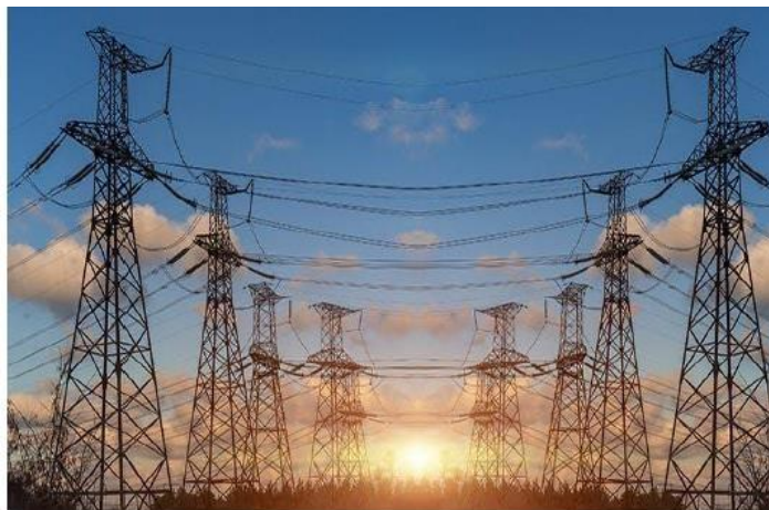
Figure I.8 : Les lignes électriques [2]
