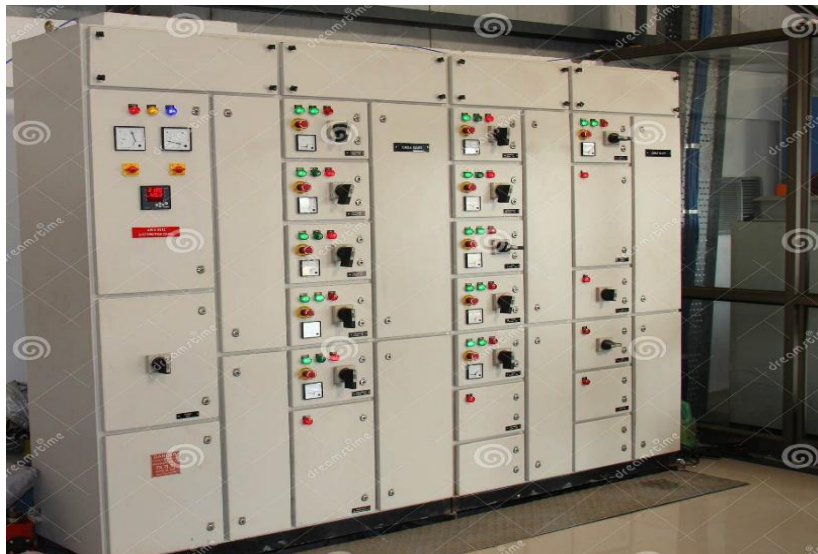
Figure I.17 : Tableau de commande.
