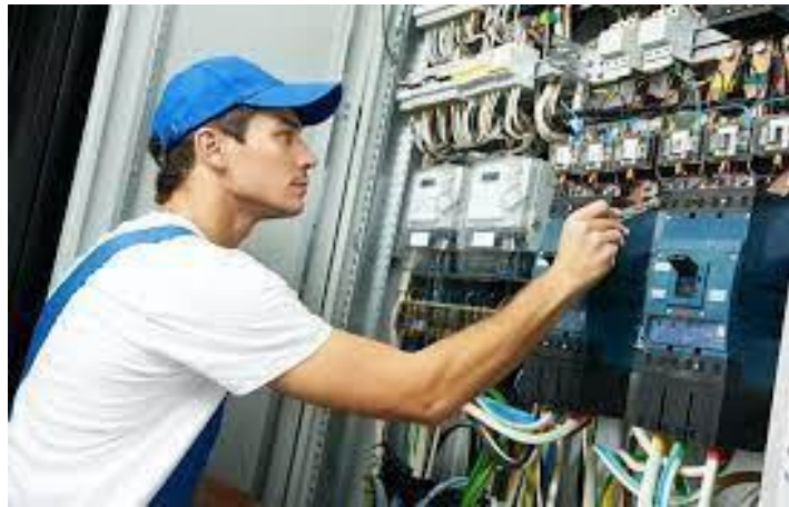
Figure I.21: Risques de pannes électriques.
