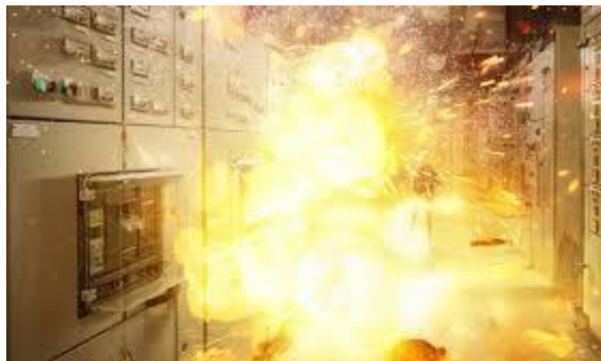
Figure I.19 : un incendie dans une salle machine industrielle.
