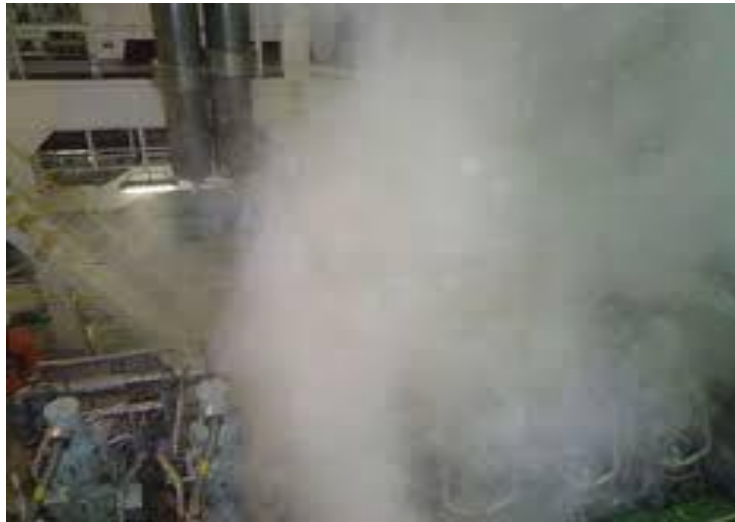
Figure I.20 : Une Fuite de fluides.
