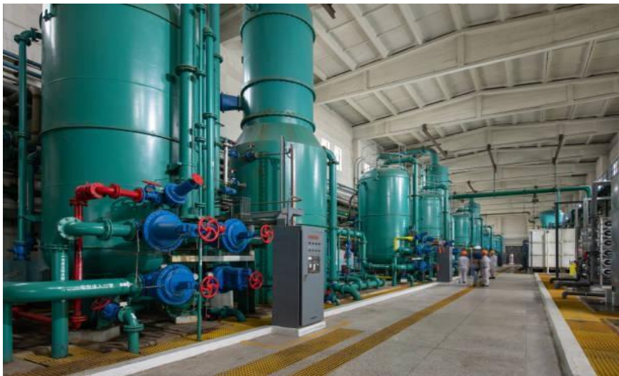
Figure I. 11 : Une Salle de Compresseurs pour le Gaz.
