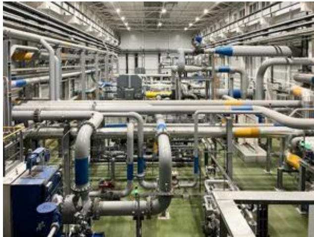
Figure I.1 : une salle machine industrielle.
