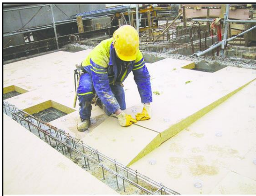
Figure 205 : Vue sur l'emplacement des panneaux de laine de roche entre les parois Source : https://energieplus-lesite.be/wp-content/uploads/2007/09/isolation-mur-creux-existant-bon-800x420.jpg
