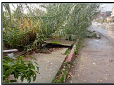
Figure 56: Vue sur l'état des trottoirs Source : Auteurs
