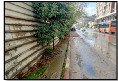
Figure 58: Vue sur l'état des trottoirs Source : Auteurs
