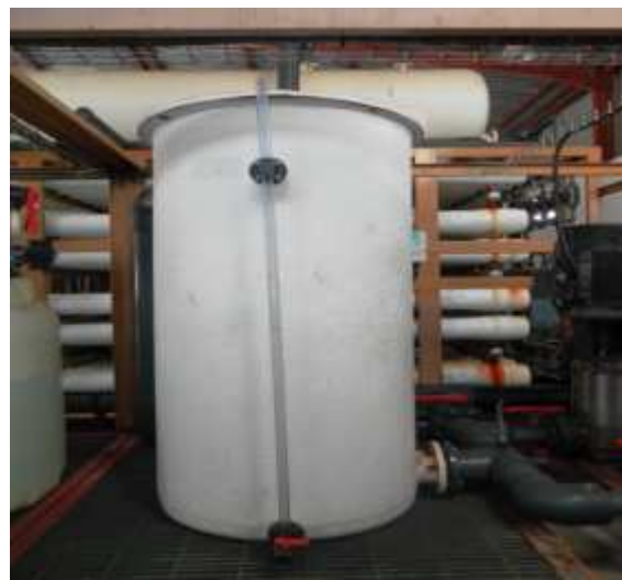
Figure n°5: Réservoir cylindrique d'eau traité
