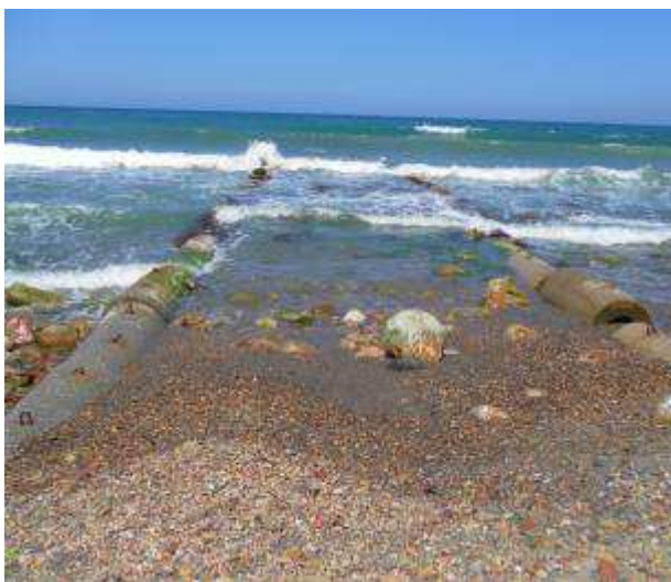
Figure n°4 : Tuyau de captage de l'eau de mer
