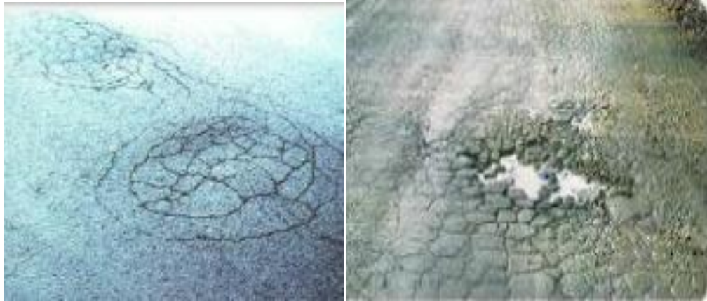
Figure I.8 : Dégradation des routes (Freeah2006).
