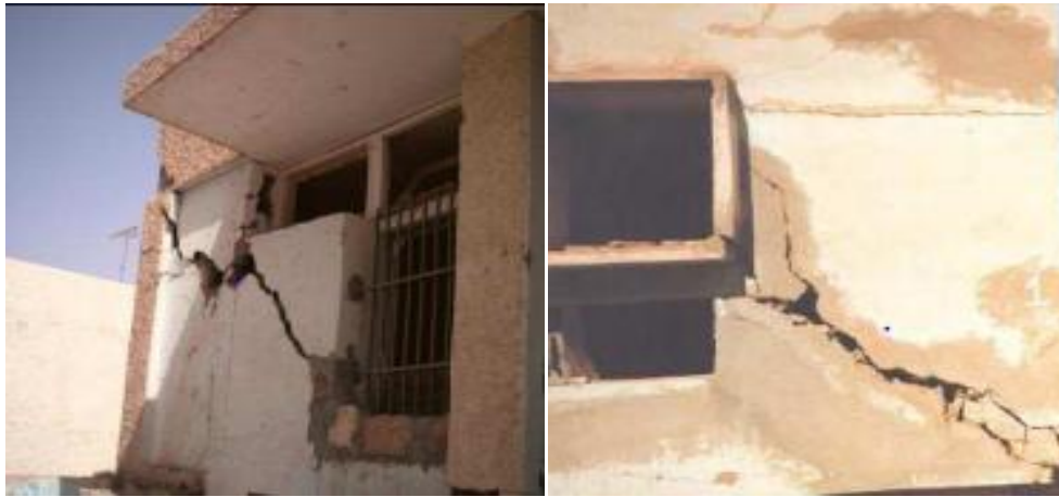
Figure I.3: Fissure sur les murs et fissures diagonales (Derriche Z et al.2002)
