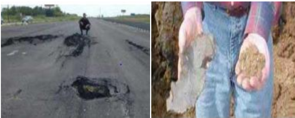
Figure .I.9 : Dégradation de chaussées (Jennings .1962).
